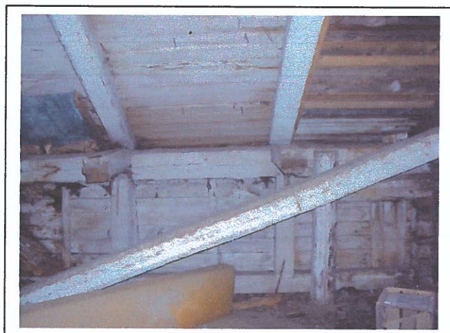
Foto 19 Vaade III eh.jrk hoone põhjapoolsele laudadest välisseinale Näha on tõstetud müürlatt ja selle taga III eh.jrk hoone põhjapoolne laudadest välissein. Müürlati jäigastamise horisontaalne talastik on laiail. Allakukkunud puittala ei ole kunagi oma funktsiooni täitnud, kuna tapid ei tööta tõmbele.
