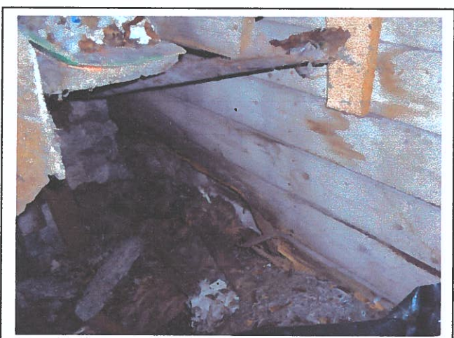
Foto 30 Näha on sadevete läbijooks I ja III eh jrk hoonete liitumiskohas. Seinad ja vahelagi selles kohas on hävinud
